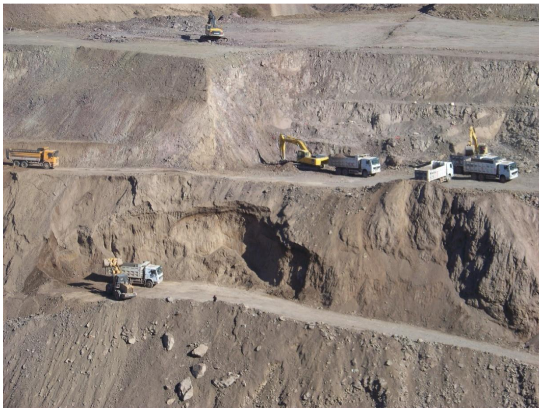
Рис. 1. Характерные нарушения местной устойчивости откосов технологических дорог при освоении месторождения Талдыбулак-Левобережный.
