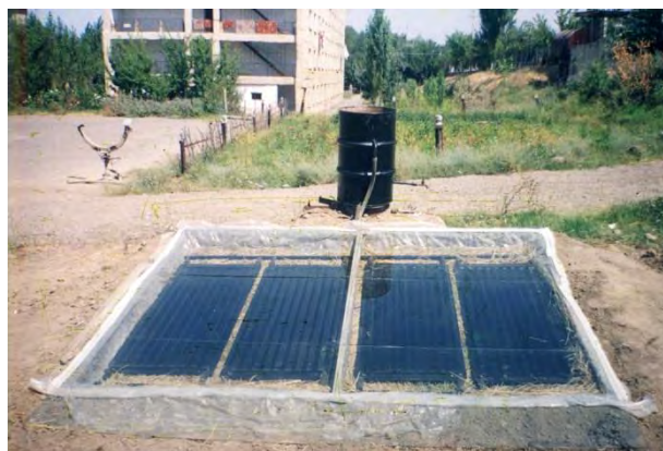
Рис. 3. Общий вид солнечной водонагревательной установки.
