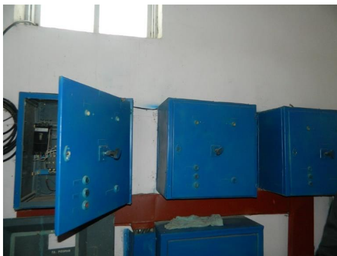
Рис. 7 – Электрический щит -подъёмник Ыссык-Атинского БДР
