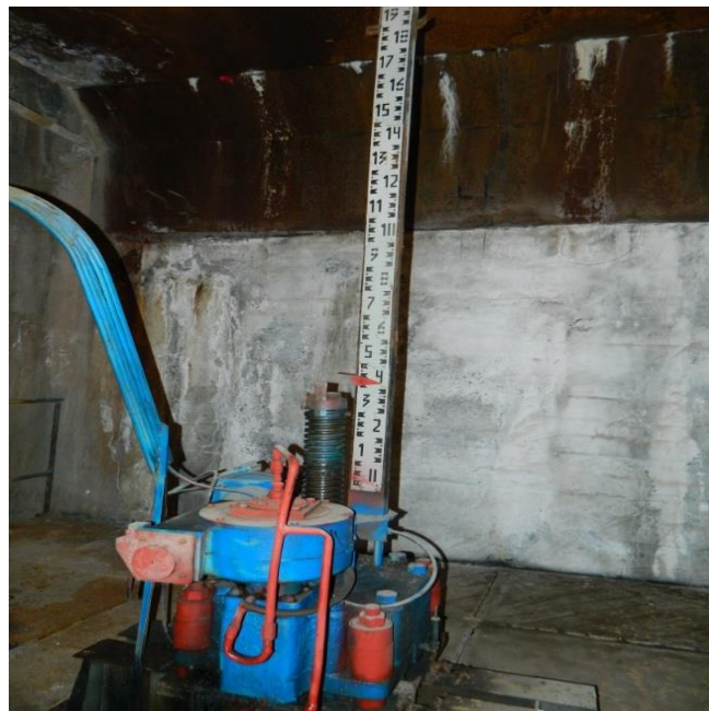
Рис. 6 - Гидравлический подъёмник Ыссык-Атинского БДР
