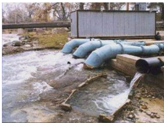
Рис. 11. Пример работы микро ГЭС в пригород г. Бишкек
