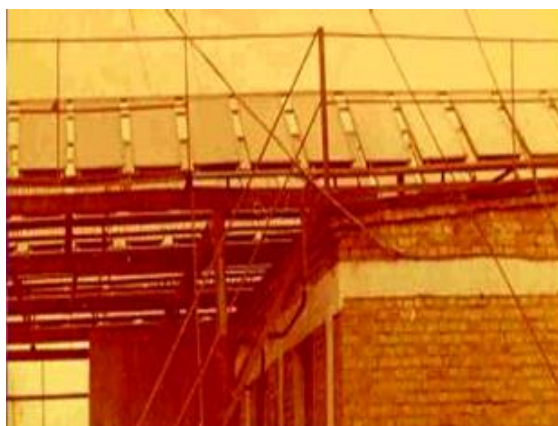
Рис.8. Комбинированная солнечная установка с котельной на МТФ
