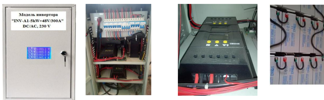
Рис.3. Общий вид инвертора, размещение контроллера заряда, автомата управления и соединения аккумуляторных батарей в исследуемой автономной ФЭС с номинальной мощностью 5 кВт
