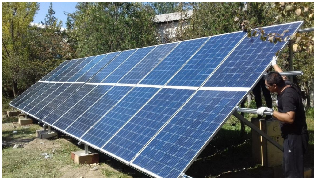
Рис.1. Общий вид исследуемой автономной ФЭС с номинальной мощностью 5 кВт при Кыргызско-Узбекском университете
