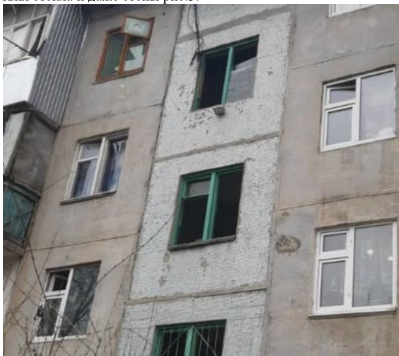
Рис.5. Состояние окон квартир и подъезда жилого дома на расстоянии 30 м
