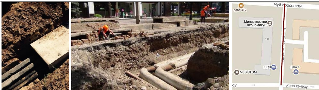
Рис. 3. Состояние магистральных и разводящих тепловых сетей г. Бишкек
