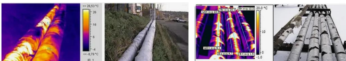
Рис. 8. Тепловизионная съемка для выявления тепловых потерь и тепловизионное обследование трубопроводов
